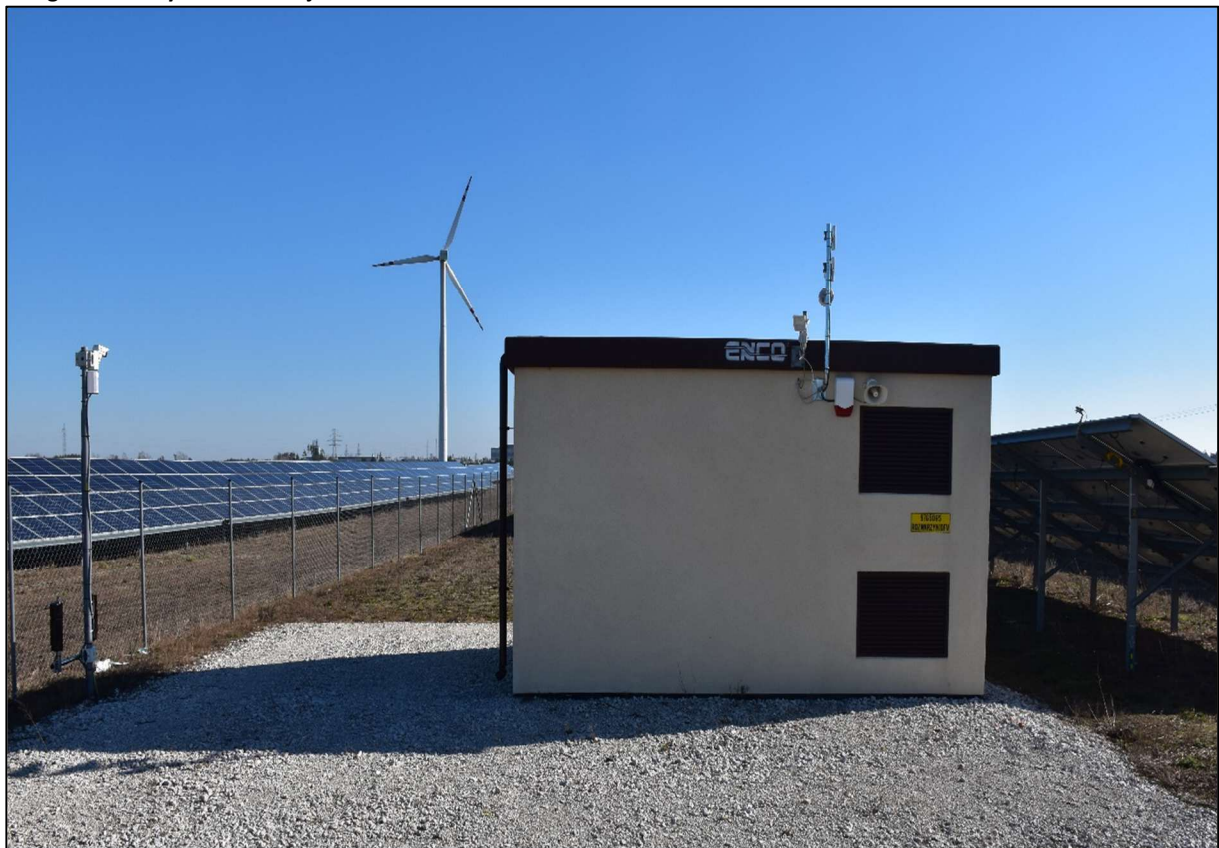
Fotografia 3. Przykładowa stacja transformatorowa.
