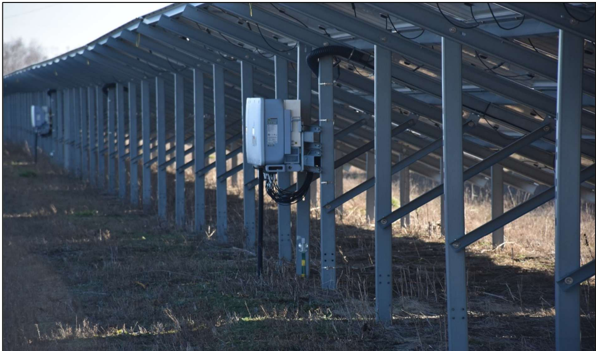
Fotografia 1. Przykładowy inwerter przymocowany do konstrukcji wsporczej.
