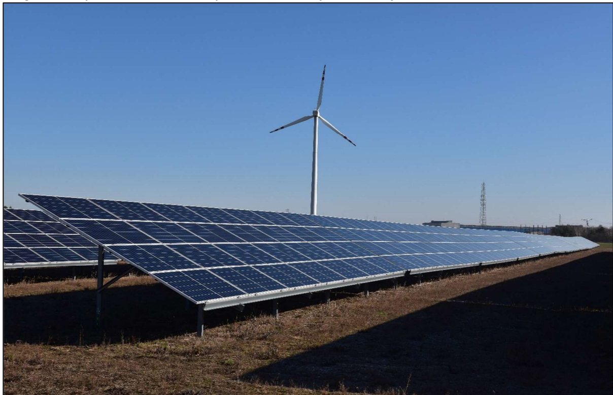
Fotografia 2. Przykładowe rozmieszczenie paneli fotowoltaicznych – czterorzędowe.
